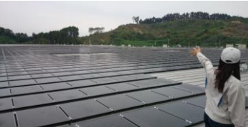
工場屋上にはもちろんパネルが！
